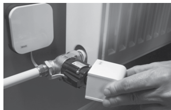
Рисунок 3.14. Вид мини-насоса, смонтированного на трубопроводе у радиатора
