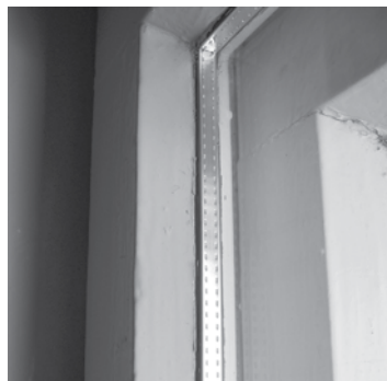
Рисунок 2.19. Окно здания после установки стеклопакетов в деревянные негерметичные деревянные рамы
