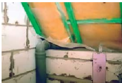
Рисунок 2.26. Пример некачественного исполнения при герметизации трубопровода
