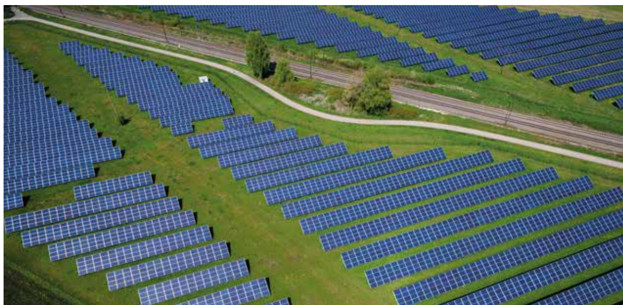
Солнечная электростанция, производящая возобновляемую энергию
