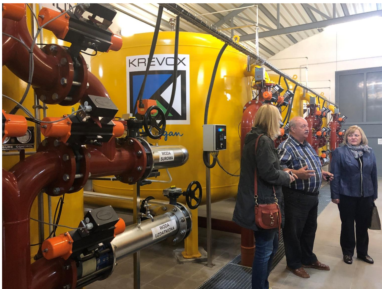
Станция обезжелезивания воды KREVOX в г. Ястребова Гора
