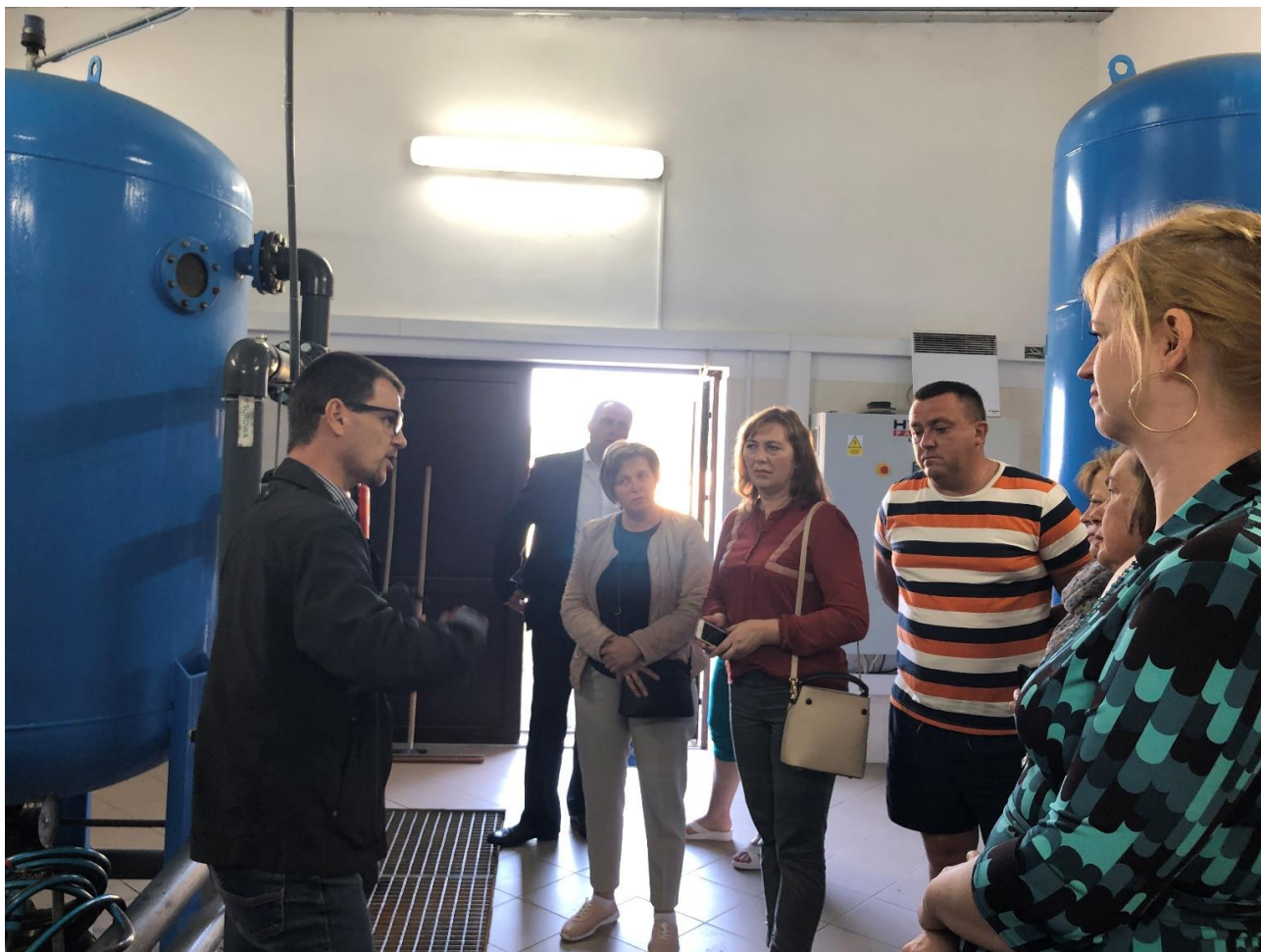
Станция обезжелезивания воды в Вейхерово
