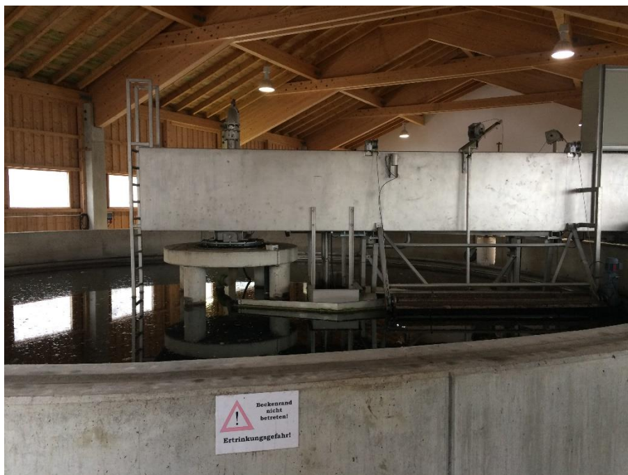
Аэротенк, находящийся в крытом помещении
