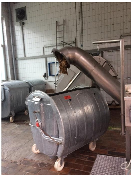
Контейнер, в который попадают осадки сточных вод
