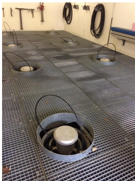
Помещение с аэротенками
