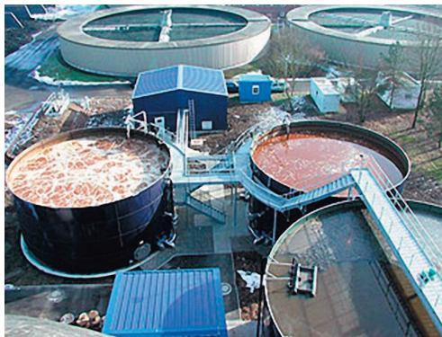
Рис. 2.24. Вид очистных сооружений с реакторами последовательного действия.
